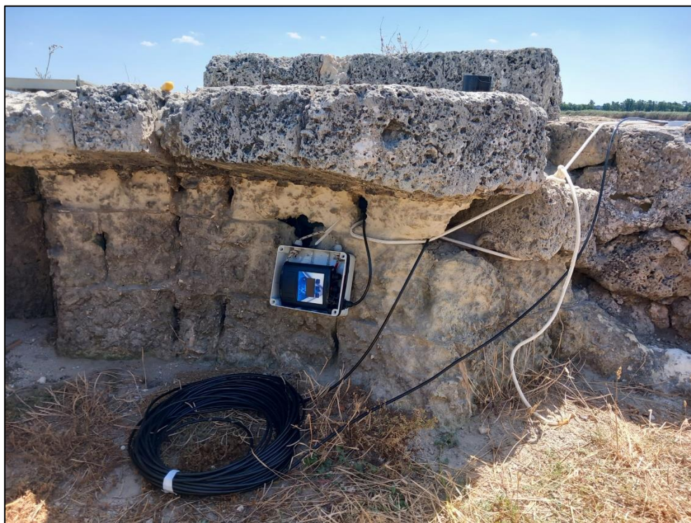
Figura 12 – Installazione mareografo – Unità di superficie
