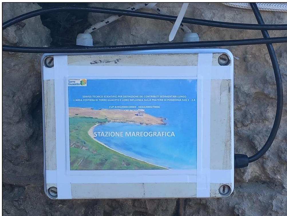
Figura 14 – Particolare della cassetta stagna in cui è stata installata l'unità di superficie
